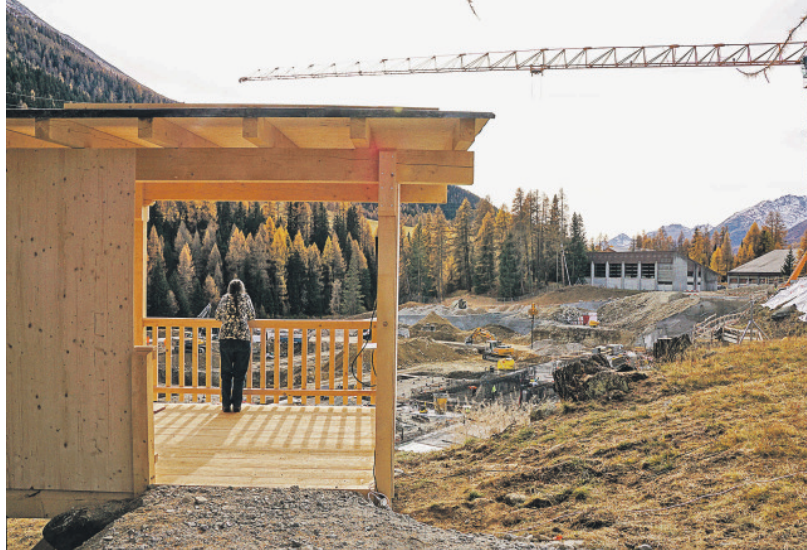
Von der frei zugänglichen Besucherplattform mit integrierten Informationen präsentiert sich dem Besucher das ganze Ausmass der 70-Millionen-Franken Grossbaustelle der ARA Oberengadin bei S-chanf. Foto: Jon Duschletta
