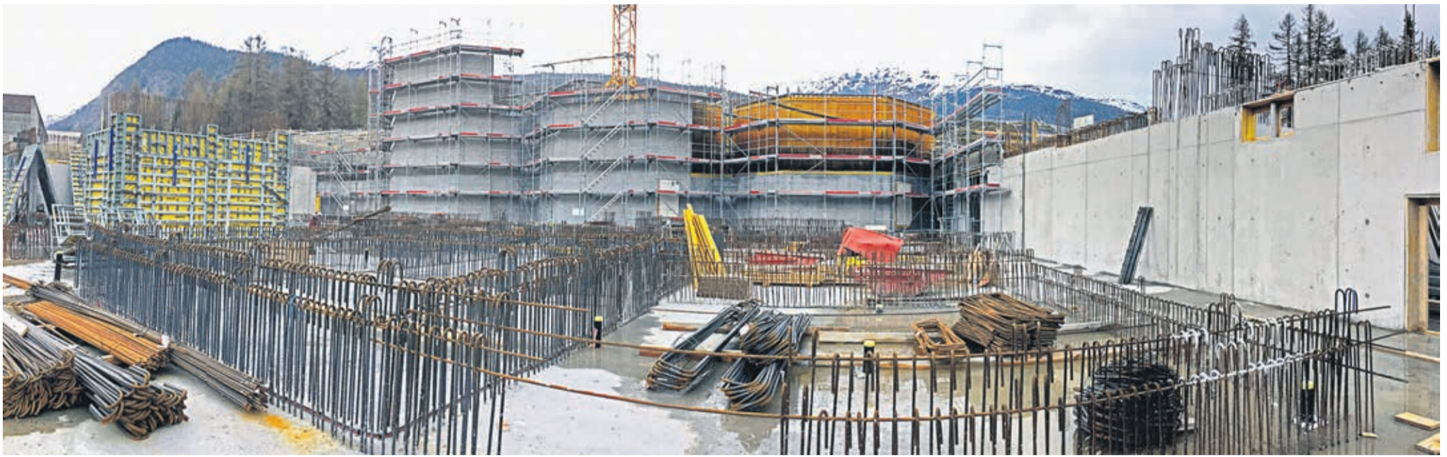
Blick auf die Industriegrossbaustelle der ARA Oberengadin bei S-chanf. Im Vordergrund entsteht die klassische, mechanische Vorreinigungsstufe, rechts davon das Blockheizkraftwerk. Im Hintergrund wachsen die drei grossen Faultürme in die Höhe. Der linke hat die Endhöhe praktisch erreicht. Links davon wird das neue ARA-Betriebsgebäude in Holzelementbauweise gebaut. Foto: Jon Duschletta
