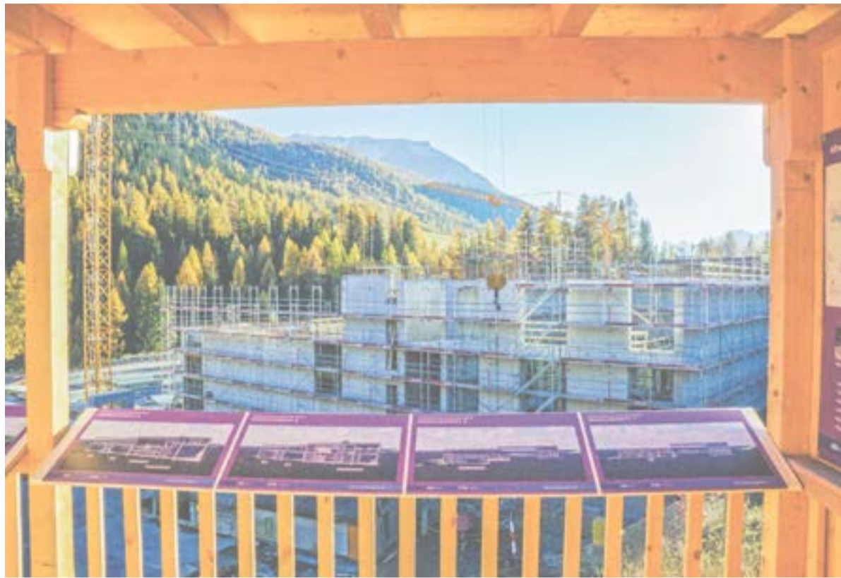
Aktueller Ausblick von der Besucherplattform auf den wachsenden Rohbau des 70-Millionen-Franken-Projekts ARA Oberengadin unterhalb der Flap bei S-chanf.
