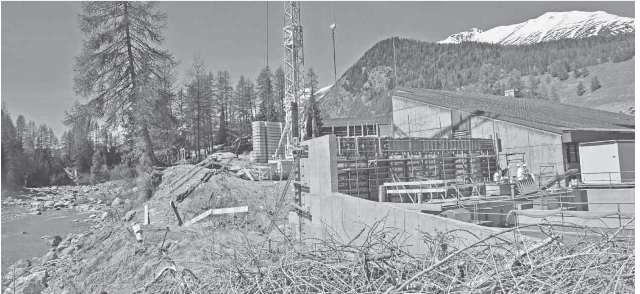
Eine Grossbaustelle am Inn bei S-chanf. Die Stützmauer aus Beton wird derzeit erstellt.
