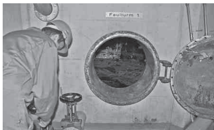
Die Faultürme werden entleert.
