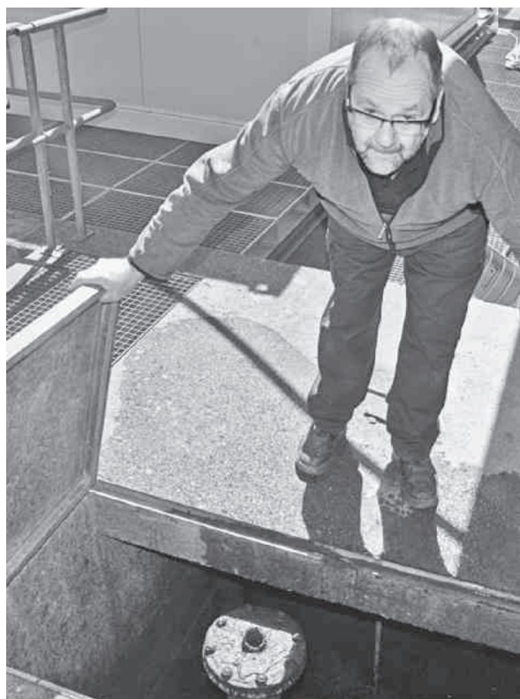
Emil Stähli begutachtet das Ende einer rostigen Leitung.
